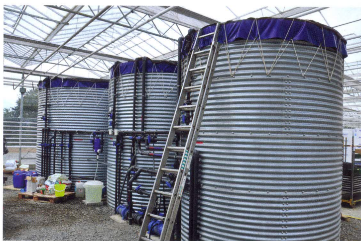
Dvě nádrže pro čistou a přebytečnou vodu a jedna pro distribuci živného roztoku
